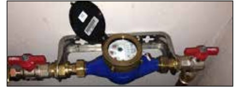
Konsollen sitter fastskruvad i väggen och stabiliserar rören.
